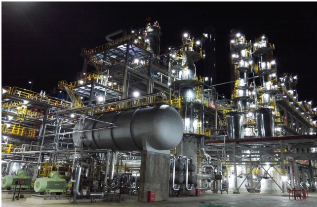
石油化工装置及其它危险场所
