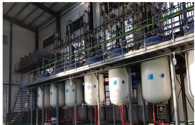
医药和化工企业车间及设备区域
