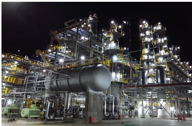
石油化工装置及其它危险场所
