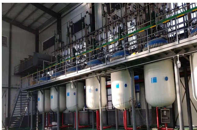
医药和化工企业车间及设备区域
