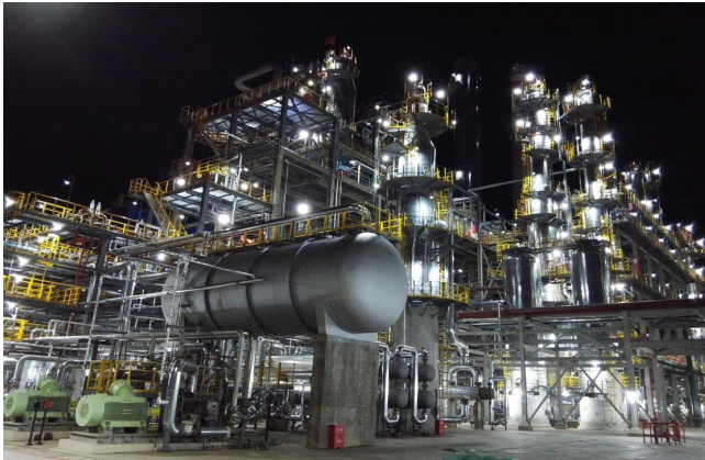
石油化工装置及其它危险场所
