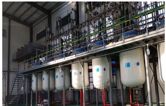
医药和化工企业车间及设备区域
